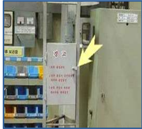
④ 크레인 점검통로 입구 잠금장치
