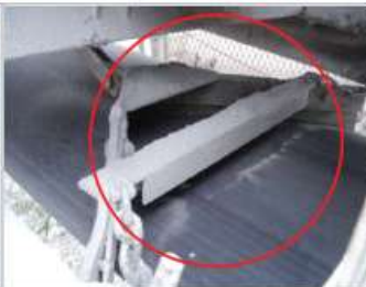
스크레이퍼* 설치 (벨트에 정착된 퇴적물 제거 장치)
