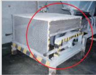
테일폴리* 방호울 설치 (컨베이어 끝단을 지지하는 폴리)
